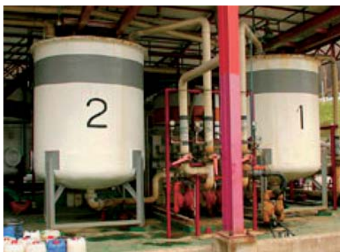
Figura 18 - Tanques de neutralización de residuos
